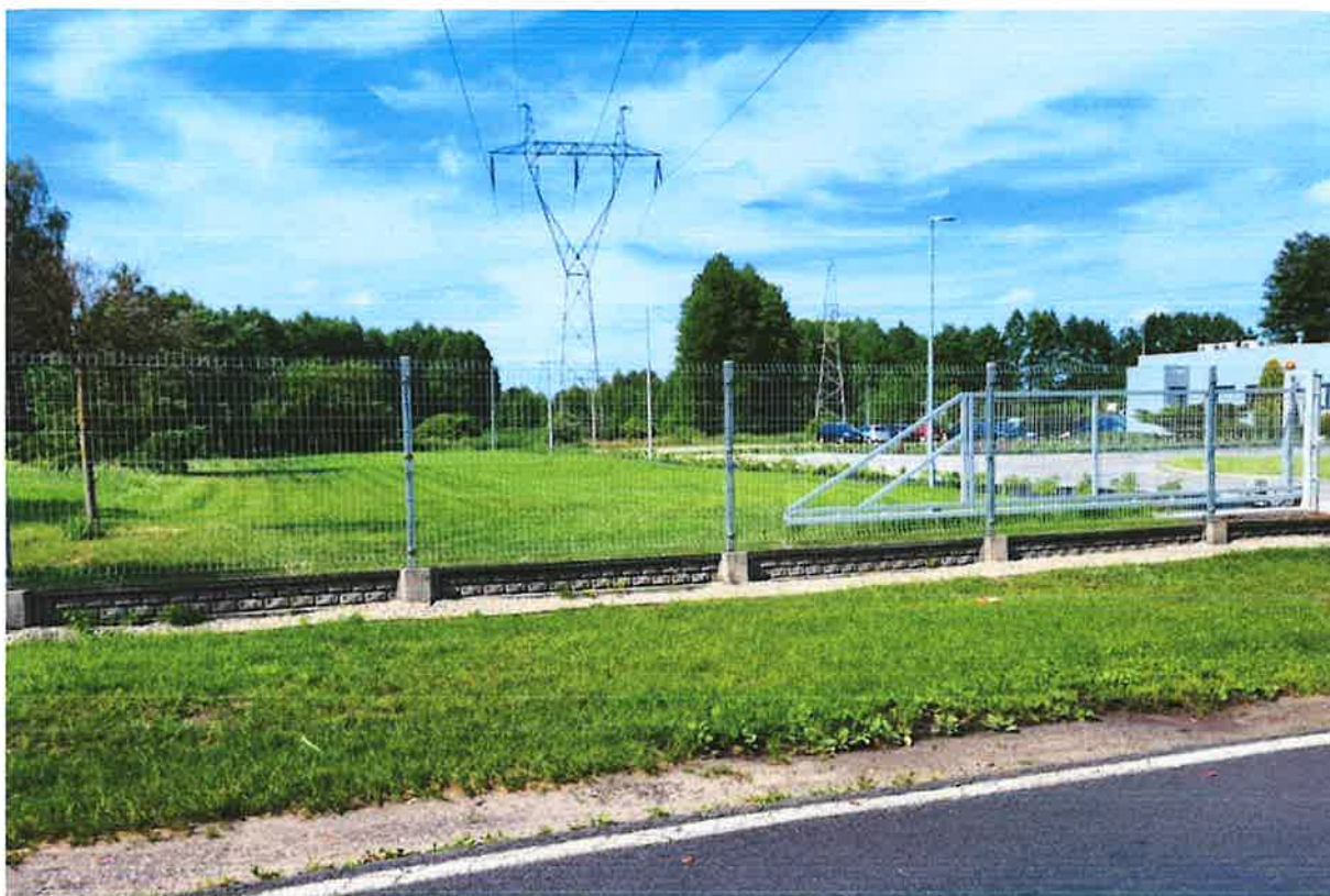
Fotografia 2. Napowietrzna linia elektroenergetyczna wysokiego napięcia w centrum obszaru objętego opracowaniem
